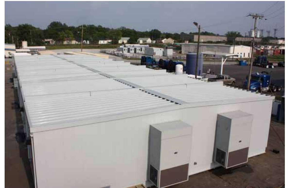
Centro de equipo de 9 piezas, 40 pies X 126 pies para planta de energía a carbón en el condado de St. Charles, Missouri (incluidas 170 toneladas de acero y hojas de metal galvanizadas, 350 galones de pintura, 11 millas de cable, más de 3.000 puntos de cableado de control terminados y 110 secciones de conjunto de equipo provisto por el cliente, atornilladas, transportadas e interconectadas)
